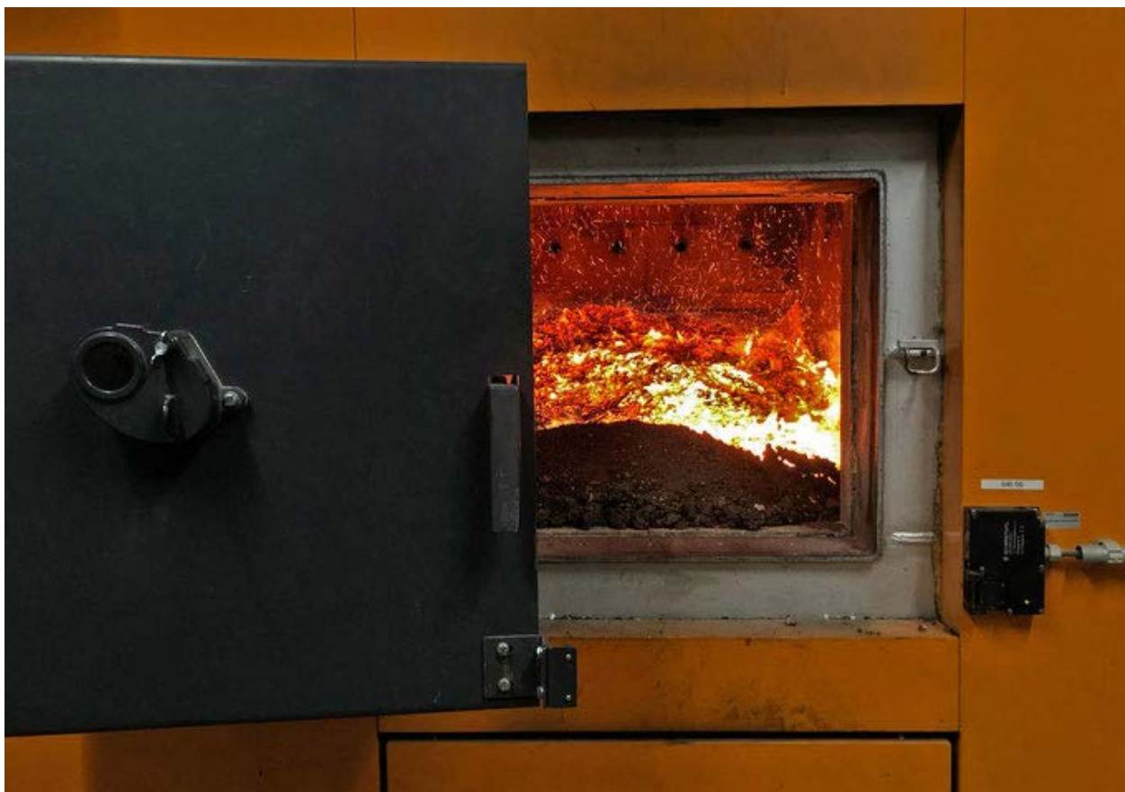
Feuerung der Fernwärme.
