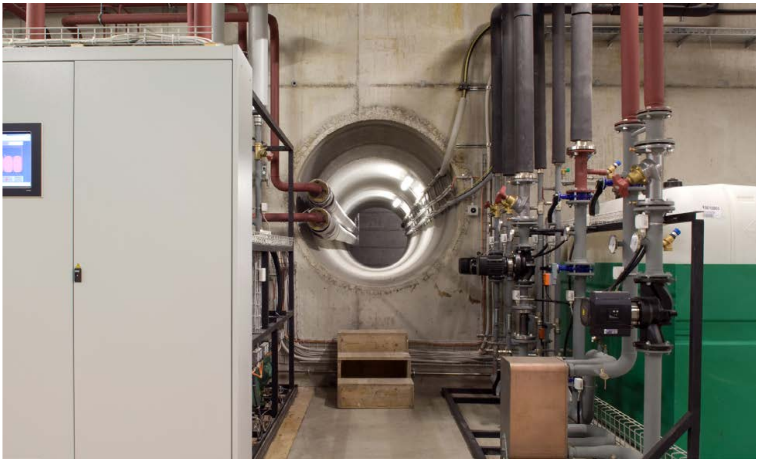
Fernwärme der Firma Salzgeber Marangun Holzbau.
